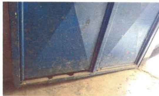
Foto 4: Puerta de la cocina en mal estado.
